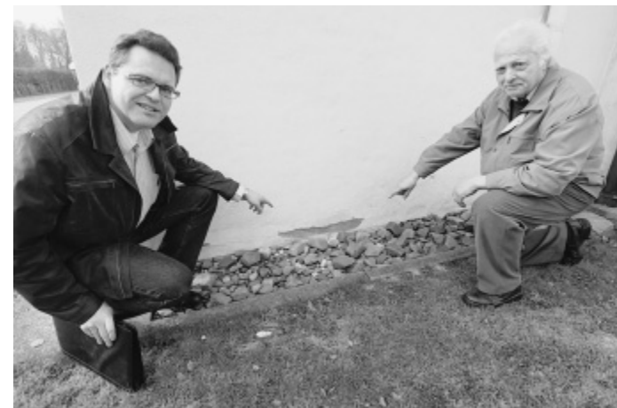
Feuchtigkeitsschäden: Architekt Volker Weege (l.) und Kirchenvorstand Hermann Lükewille deuten auf die Schadstelle.
