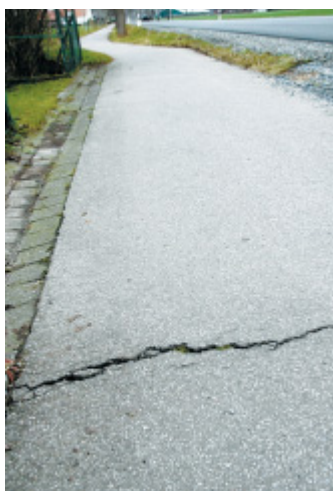
Riss im Asphalt: Am Radweg entlang der Sürenheider Straße bemängelt der ADFC vor allem den schlechten baulichen Zustand.
