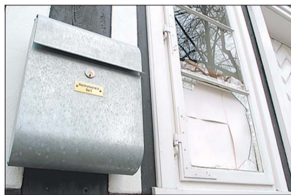
Nach dem Einbruch notdürftig verschlossen: Die Scheibe neben dem Eingang fiel einem Pflasterstein zum Opfer. Dann griffen die Diebe zu.
